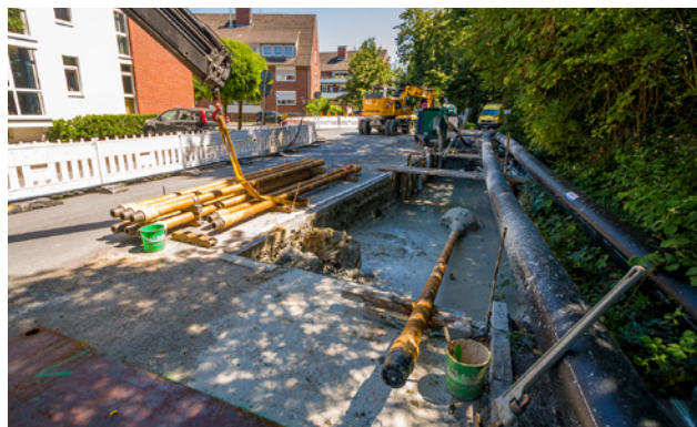
Bild 1: Von der Zielgrube aus erfolgen die Aufweitungen des Bohrloches in Richtung der Startgrube
