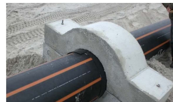
Rohrleitung mit Auftriebsicherungen: Mit ihrer Hilfe wurden die neuen Entwässerungsleitungen in einen Rohrgraben auf dem Meeresboden versenkt.
