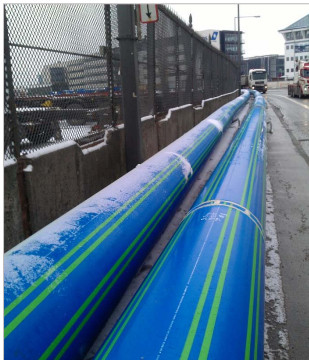
Die Rohrenden wurden stumpf miteinander verschweißt, die Nachumhüllung des Schweißbereichs erfolgte mittels Extrusionsschweißen
