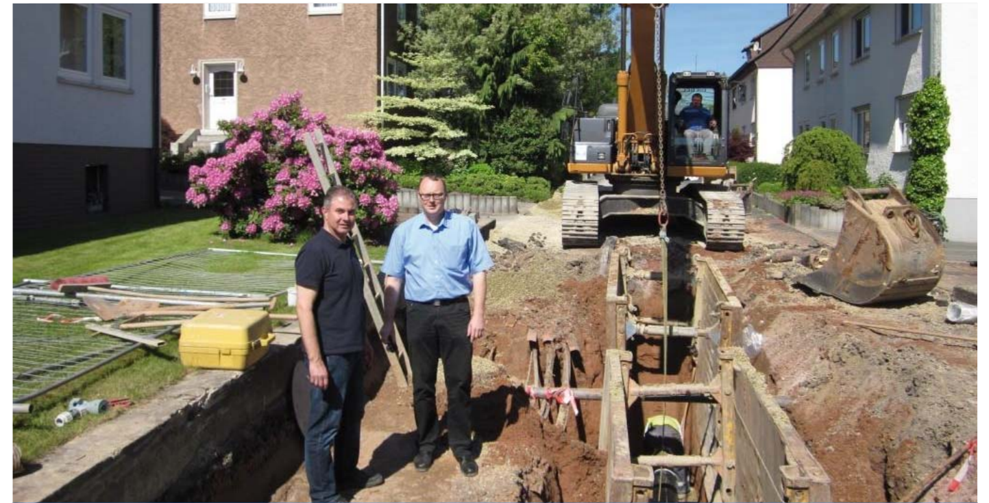
Planer Mario Deist und Giebel-Bau Geschäftsführer Christoph Hau testen das Handling des egefuse® Systems auf der Baustelle.
