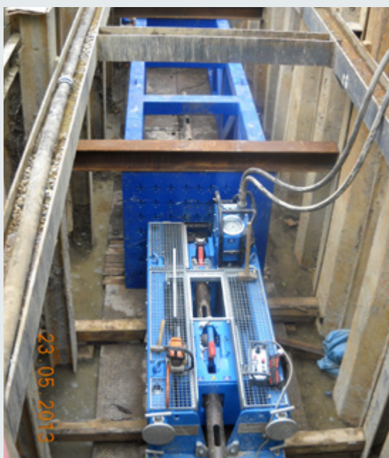
Bild 4: Gestängeanlage in Maschinengrube
