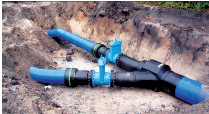
Bild 3: Formteilbaugruppen/Schweißkolonnen und Absperrarmaturen
