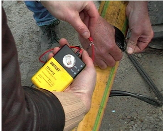
Abbildung 6: Nachweis der Nichtbeschädigung mit einem Durchgangsprüfer
