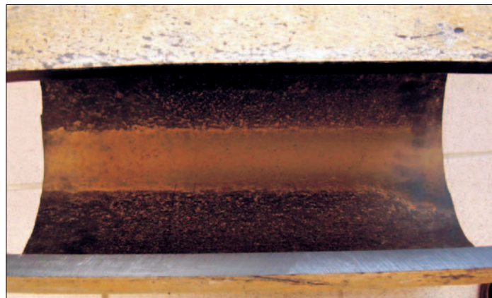
Bild 6: Aufgeschnittenes Rohr aus Bio-Kanaldruckleitung
