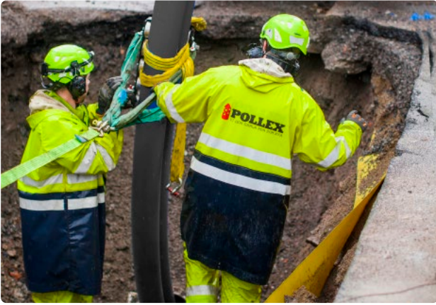
Rohreinzug über kleine Baugruben, geringer Platzbedarf für die Baustelle Pipe insertion in small pits, low space requirements on site
