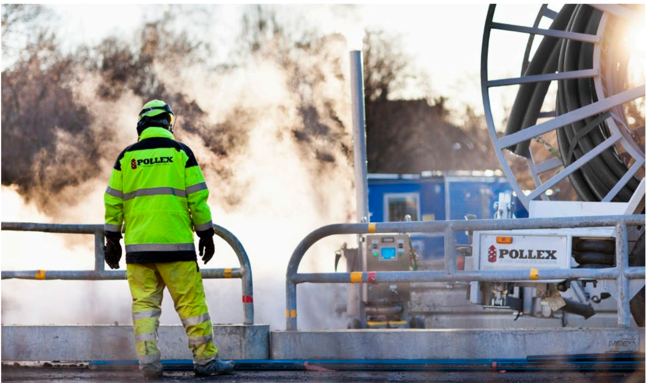
Aufstellen eines egeLiners mit Wasserdampf Resizing of an egeLiner® using hot steam
