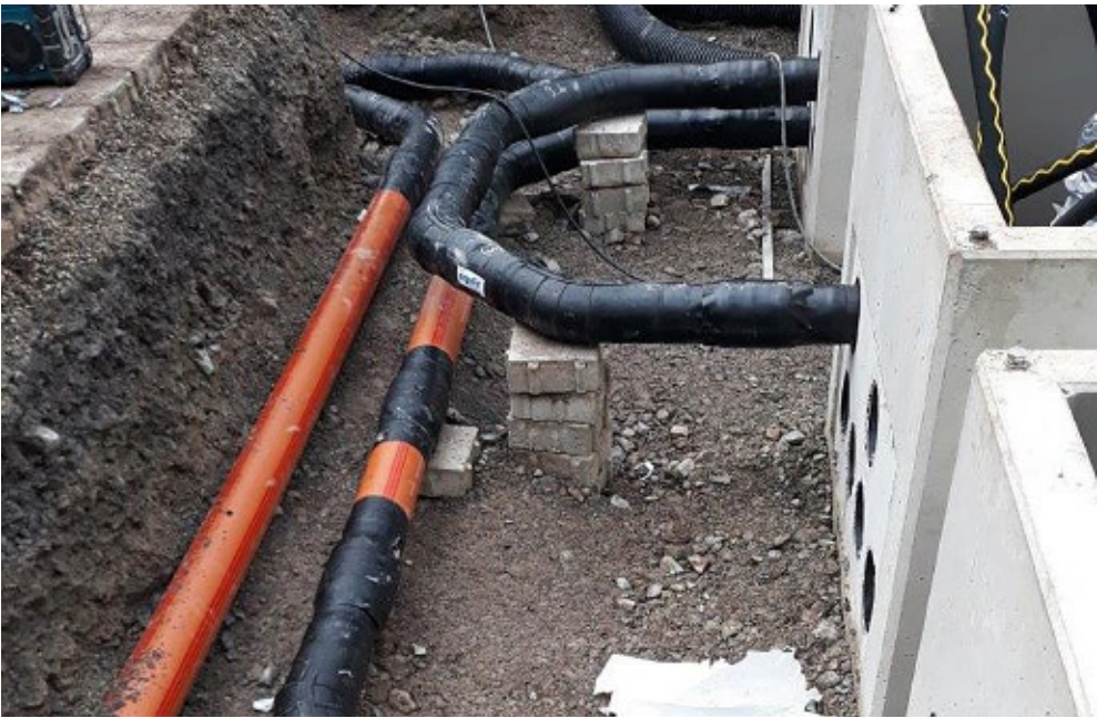
Leitungsinfrastruktur von überwachten Schnell-Ladestationen / Pipeline infrastructure of monitored quick charging stations
